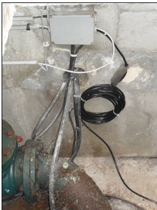
Photographie 5 : Evacuation câbles électriques de la chambre
