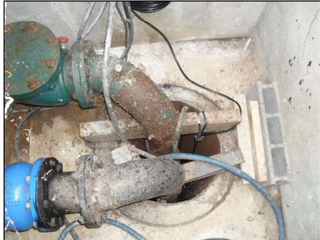
Photographie 2 : Colonne des pompes
