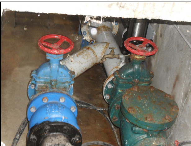
Photographie 3 : Vannes de régulation des débits de pompage et robinet de prélèvement eau brute
